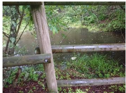
図3 針金が破損した木柵
